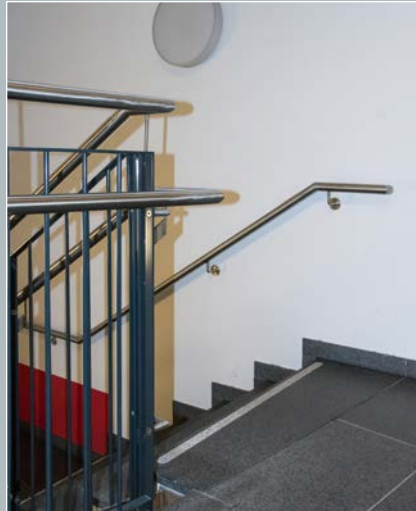
zweiter Handlauf unterhalb der Absturzsicherung
